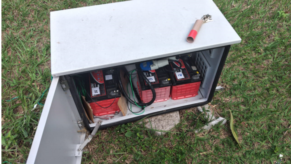
Figura 3.6: Baterias organizadas em uma caixa de proteção
