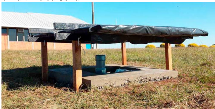
Figura 3.7: Foto da estrutura necessária para a instalação de um magnetômetro, mostrando a base de concreto, e a cobertura, na estação magnética de São Martinho da Serra.
