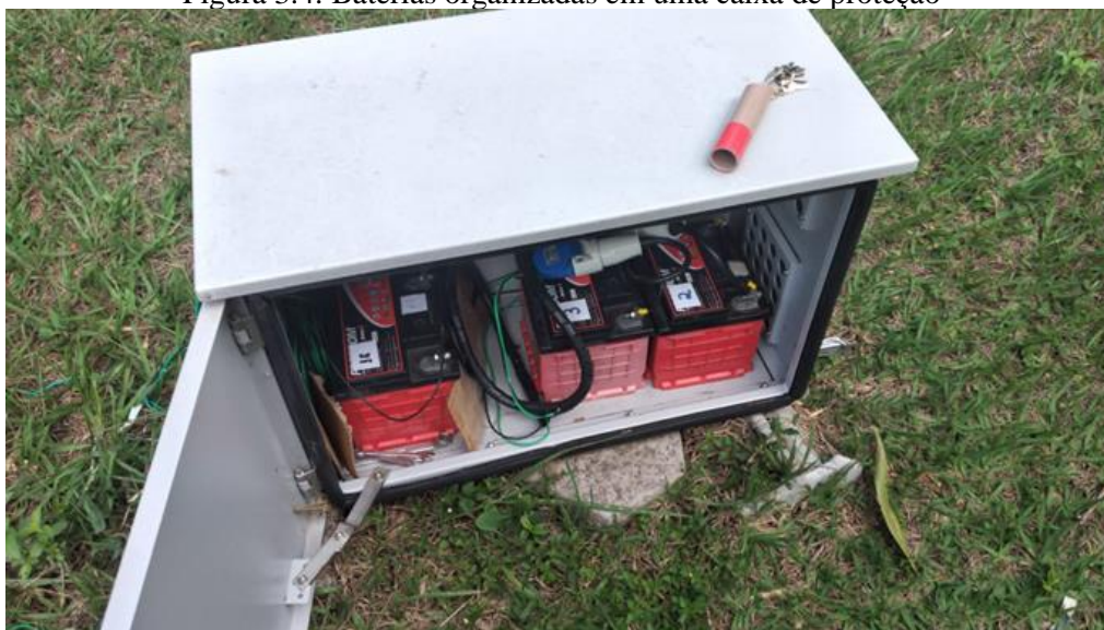
Figura 3.4: Baterias organizadas em uma caixa de proteção
