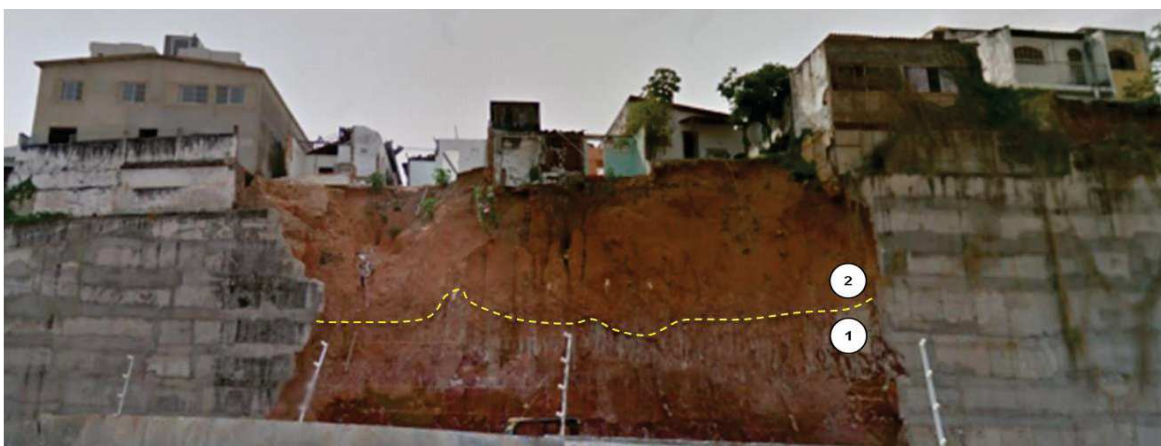
Figura 17- Após queda do muro de arrimo, o talude expõe materiais inconsolidados residuais da Formação Barreiras em (1) e Formação Potengi em (2).
