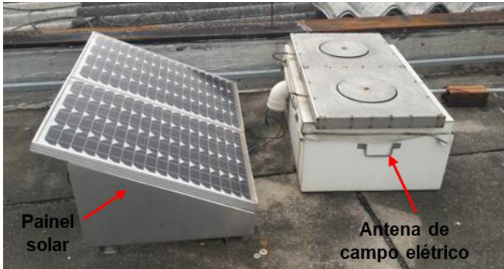
Figura 3.7: Antena de campo elétrico utilizada e painel solar.
