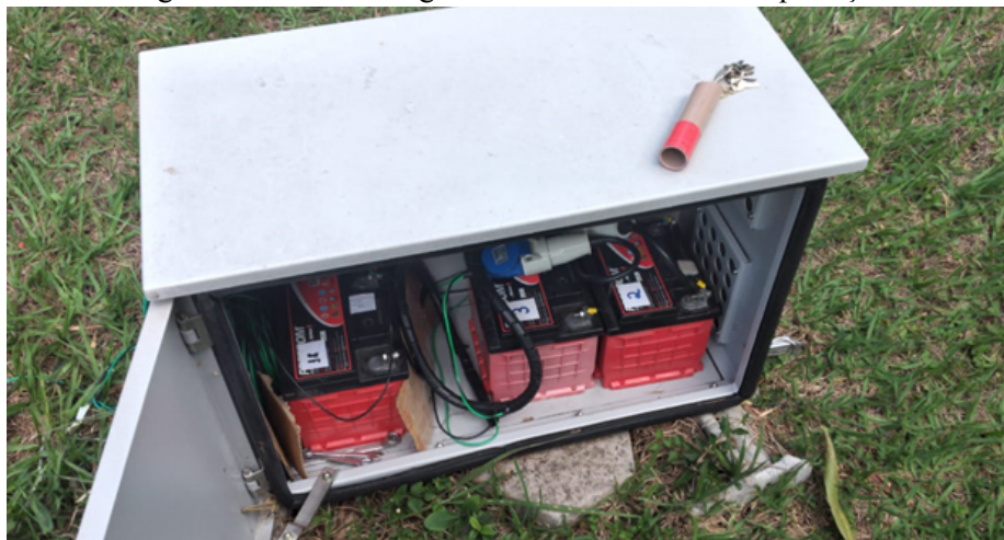
Figura 3.6: Baterias organizadas em uma caixa de proteção
