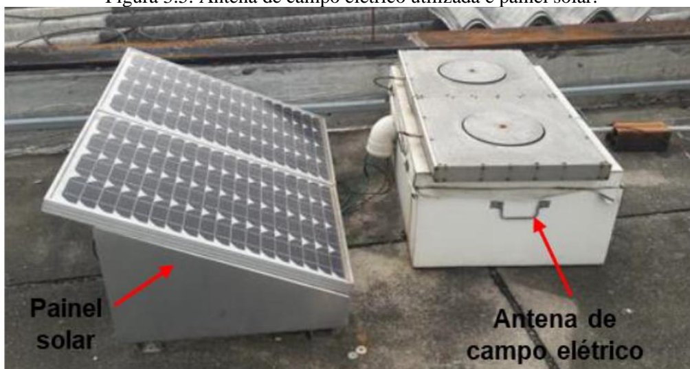
Figura 3.5: Antena de campo elétrico utilizada e painel solar.
