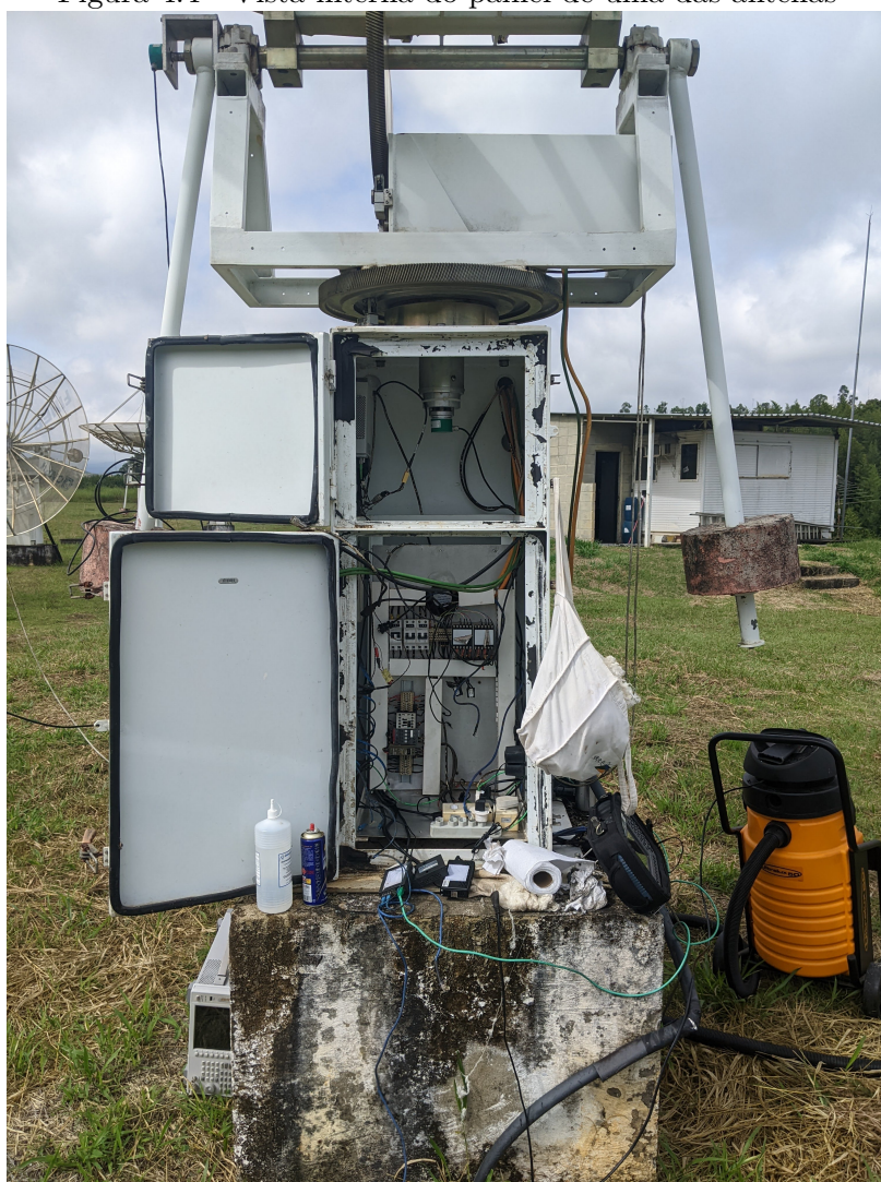
Figura 4.4 - Vista interna do painel de uma das antenas
