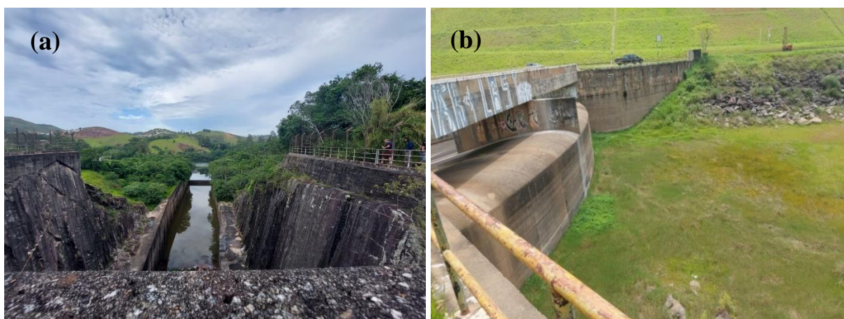
Figura 4. Vertedores do Reservatório da UHE Paraibuna (esquerda) e do Reservatório da elevatória do Jaguari (direita).
